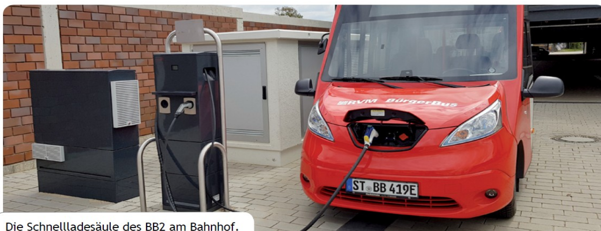
Die Schnellladesäule des BB2 am Bahnhof.
